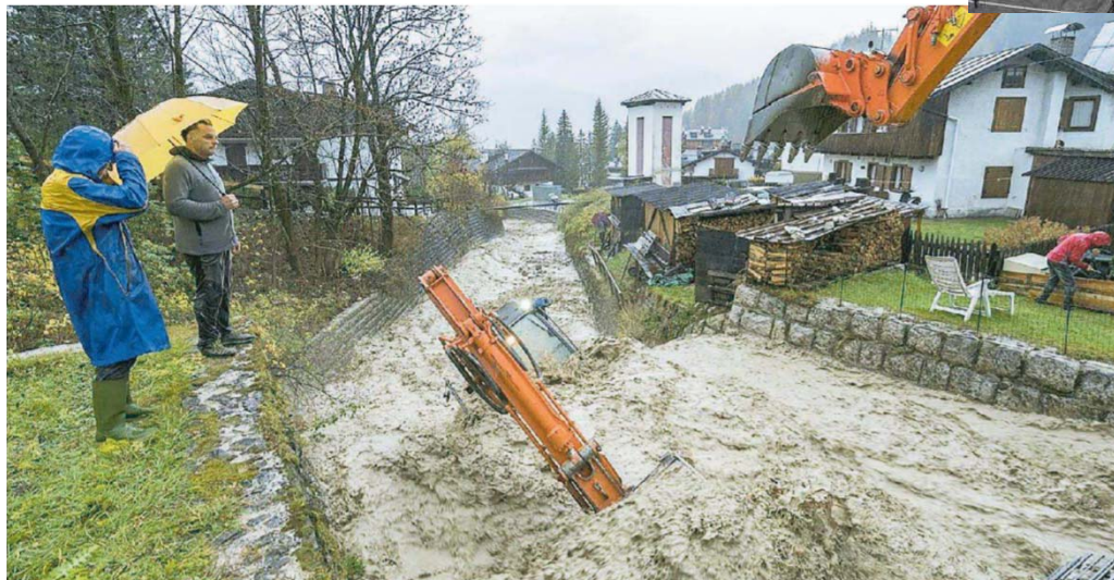
La ruspa rovesciata dentro il torrente Bigontina ad Alverà, salvo l'operaio che manovrava il mezzo (Foto Dario Bellodis)
