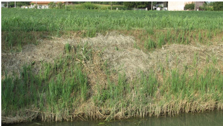
Fiume Dese, effetti del mancato asporto della vegetazione, sulla sponda interna dell'argine.
