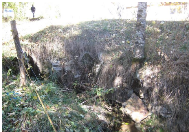
Velo veronese – Loc. Mulbese, Valle non demaniale –cedimento e sottoescavazione delle difese spondali che minacciano la stabilità della strada provinciale.
