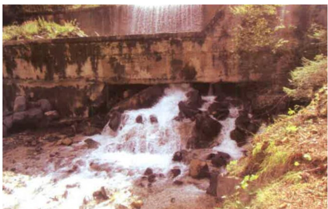
Fondazione della contro briglia da ripristinare in Comune di Selva di Cadore
