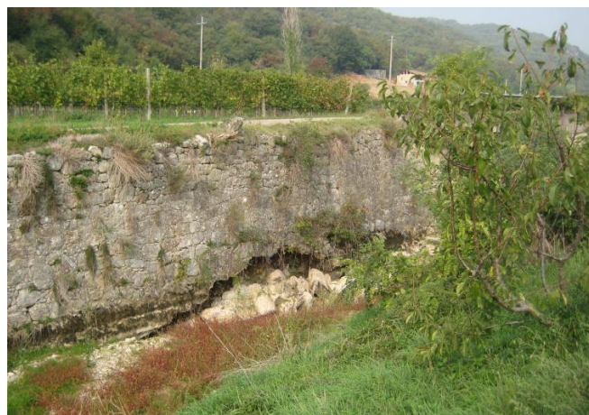
Mezzane di Sotto – Loc. Sul Vago, Progno di Mezzane Cedimento del muro spondale con conseguente pericolo per la stabilità del ciglio stradale.
