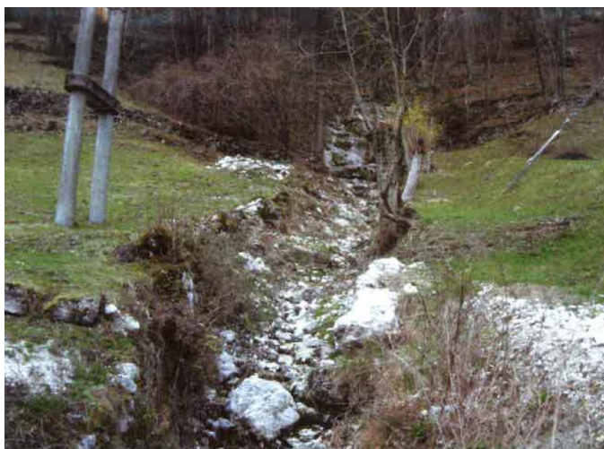
Tratto di canale da regimare con canalizzazione in loc. La Muda di Valle Agordina (BL)
