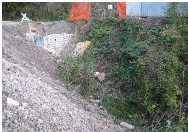
Negrar – Loc. Casalini, Vaio S. Biagio –fenomeni erosivi che minacciano la stabilità di sponde e fondo alveo. È prevista una nuova briglia a valle dell'invito realizzato nel 2017
