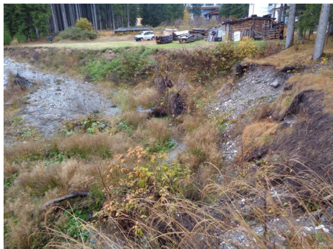
Fenomeni erosivi presenti sul T. Padola in loc. Moié sponda sx.
