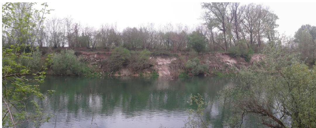
Tratto in erosione oggetto di consolidamento con vista dalla sponda in sinistra orografica (intervento 2)
