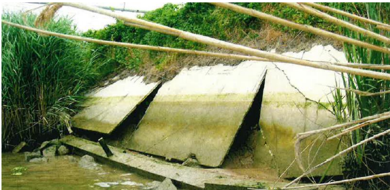
Opere di difesa ammalorate e paesaggisticamente incongrue da sostituire
