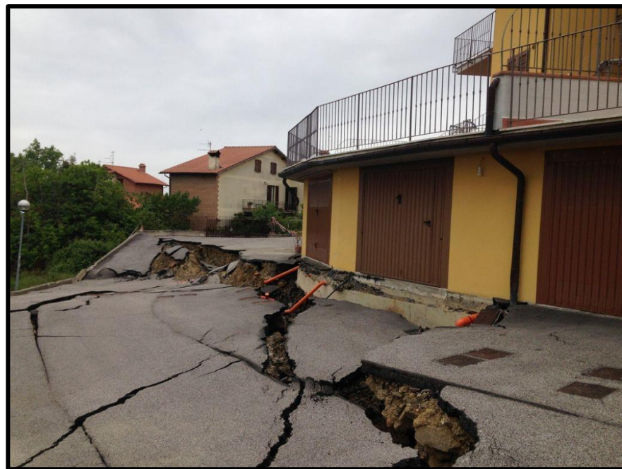
Frane compesse e grandi frane in terra.
